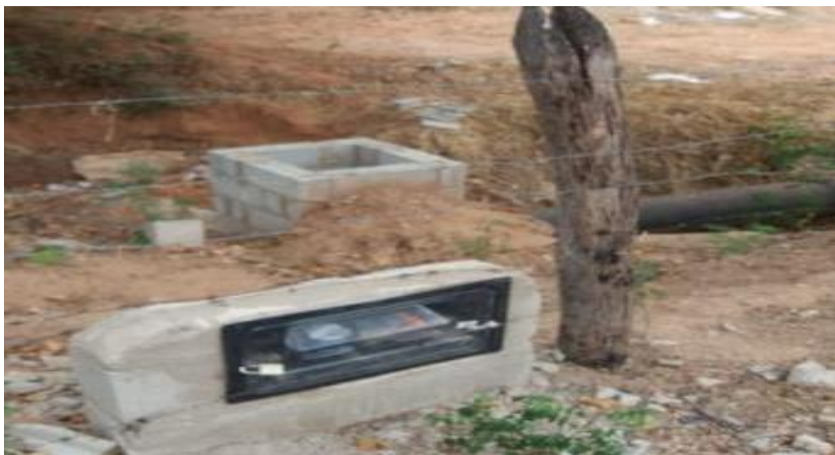
Figura 42 – Hidrômetro na Rede Localidade de Mulungu Fonte: INSTITUTO GESOIS, 2021.
