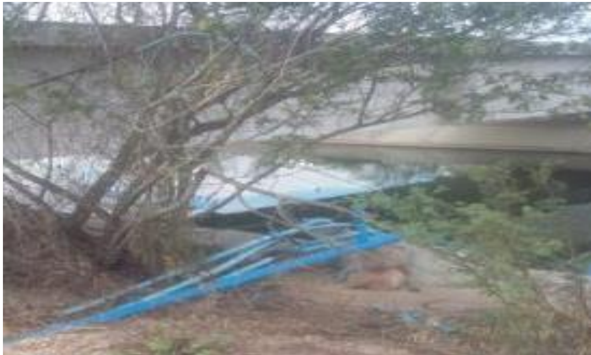
Figura 118 – Captação no Canal Localidade Pilãozinho Fonte: INSTITUTO GESOIS, 2021.
