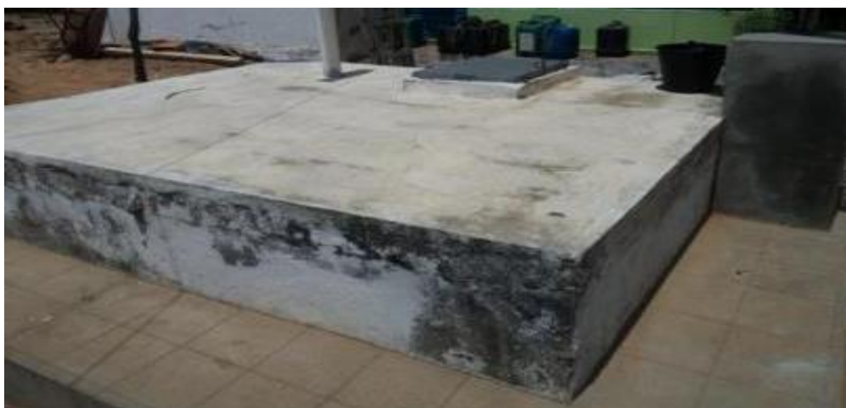
Figura 89 – Caixas D'água Localidade Boa Vista (Preguiçoso)
