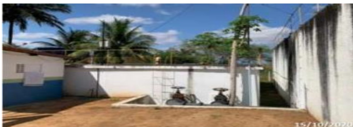
Figura 29 – Reservatório 2 EEAT-04 de Água Branca Fonte: ARSAL, 2020.
