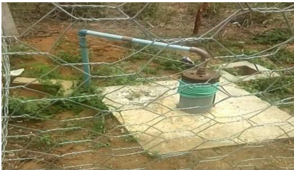
Figura 114 – Poço Subterrâneo Localidade Serra Grande Fonte: INSTITUTO GESOIS, 2021.
