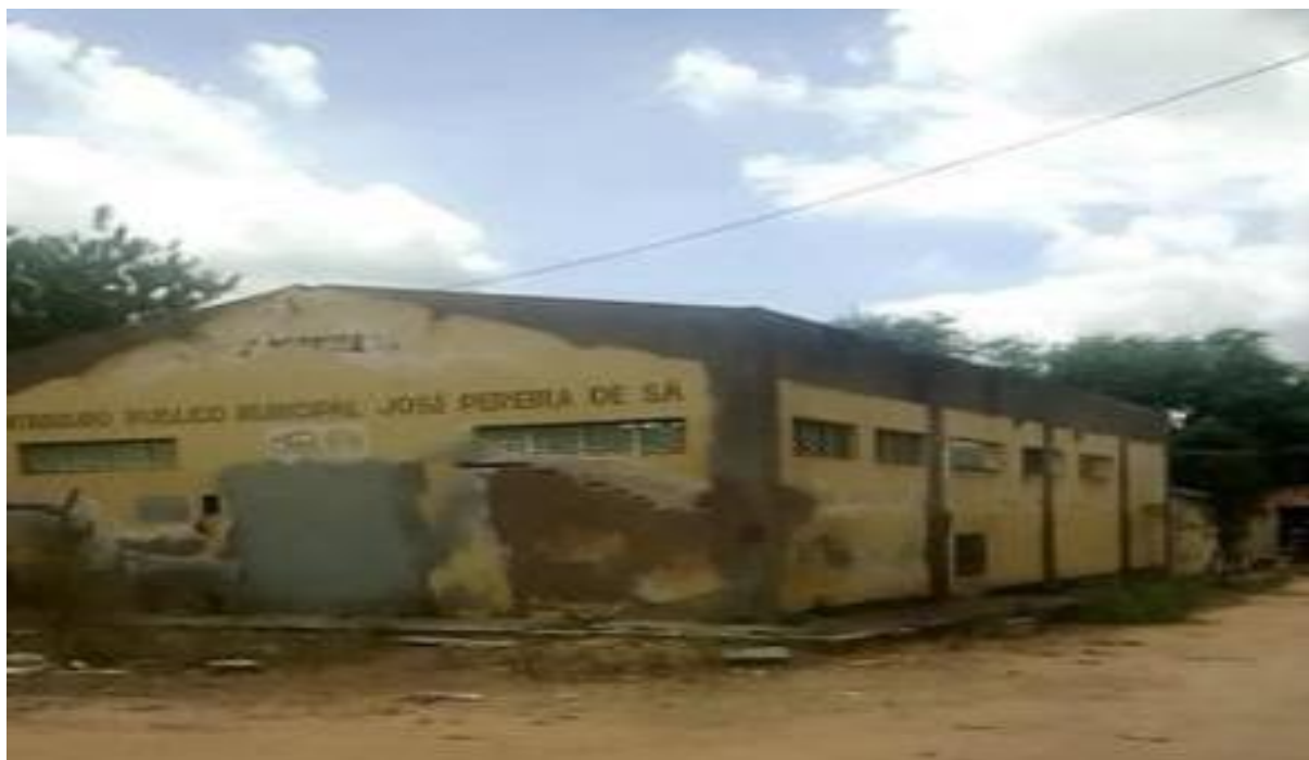
Figura 39 – Matadouro Desativado da Localidade de Tabela
