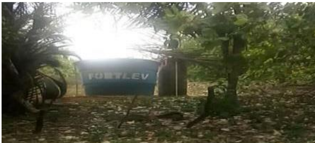
Figura 60 – Caixa d'água SAA Sítio Barrado Fonte: INSTITUTO GESOIS, 2021.
