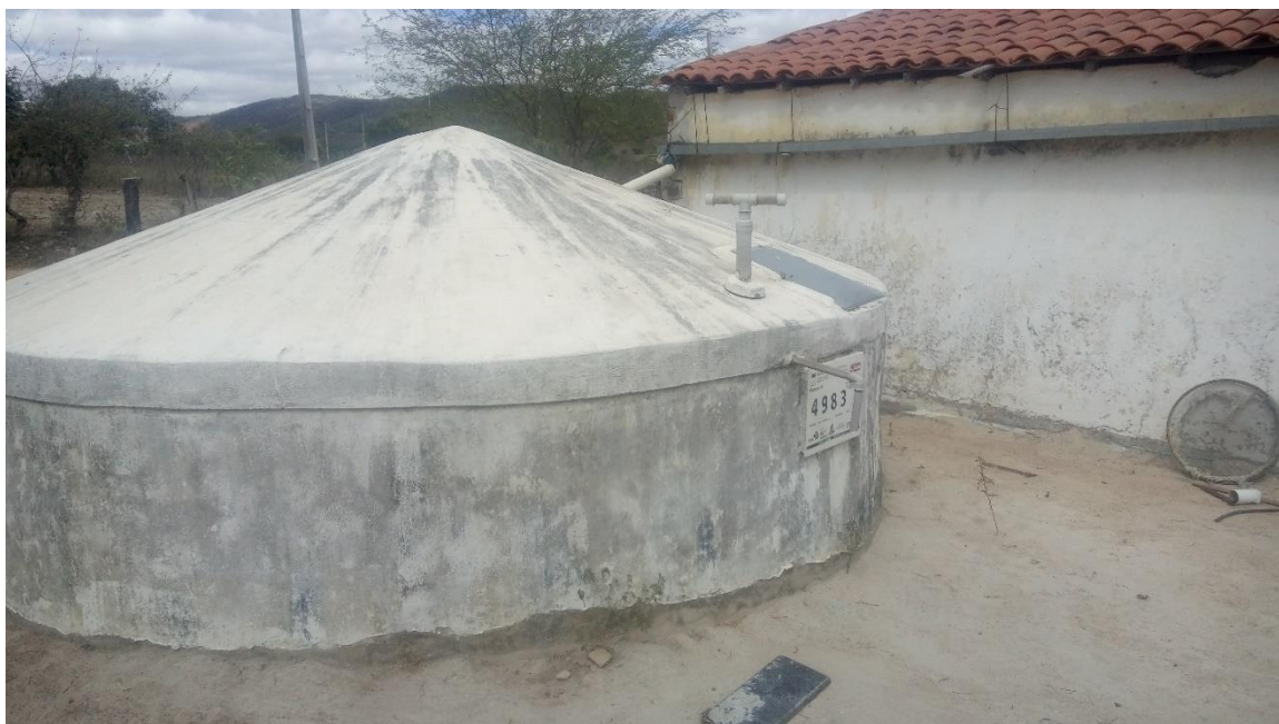
Figura 71 – Cisterna para Captação de Água da Chuva e Armazenamento de Água Trazida por Carro-Pipa na Comunidade Maxi Fonte: INSTITUTO GESOIS, 2021.
