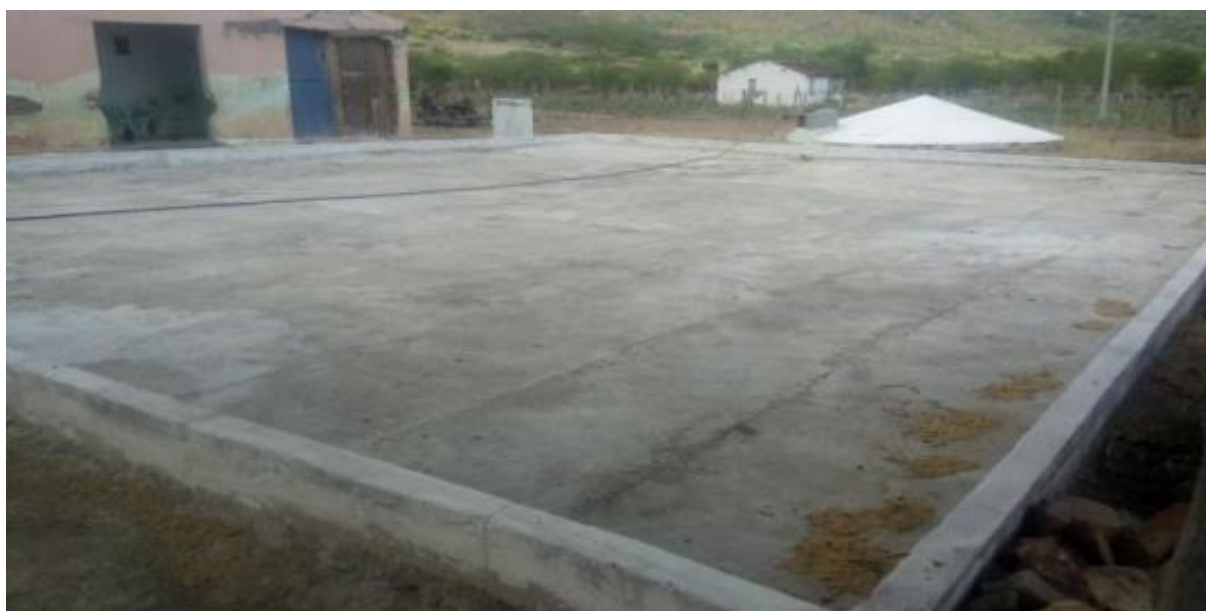
Figura 45 – Cisterna Calçadão Localidade de Lagoa das Pedras Fonte: INSTITUTO GESOIS, 2021.
