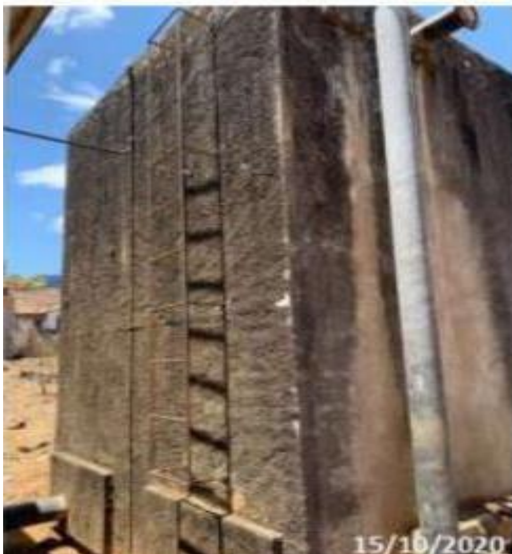
Figura 32 – Reservatório R1, EEAT Auxiliar de Água Branca Fonte: ARSAL, 2020.
