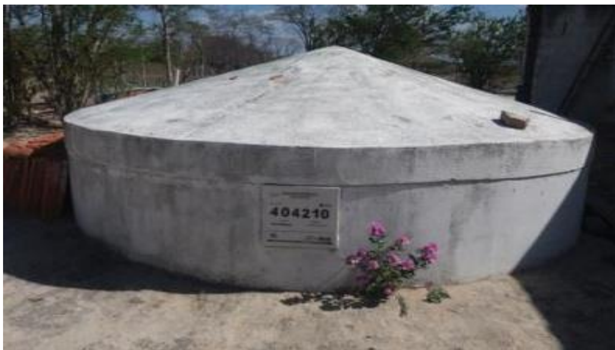
Figura 101 – Cisterna Localidade Serra do Meio
