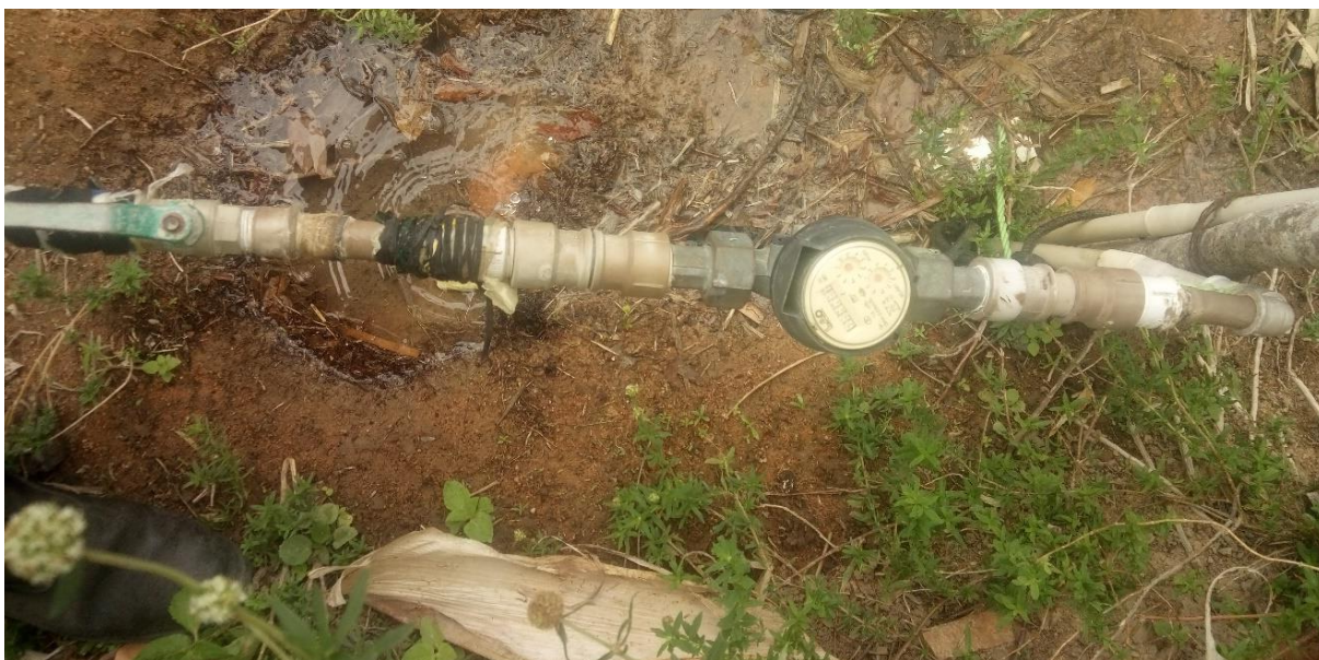
Figura 76 – Hidrômetro na Rede de Abastecimento da Comunidade Valentim Fonte: INSTITUTO GESOIS, 2021.
