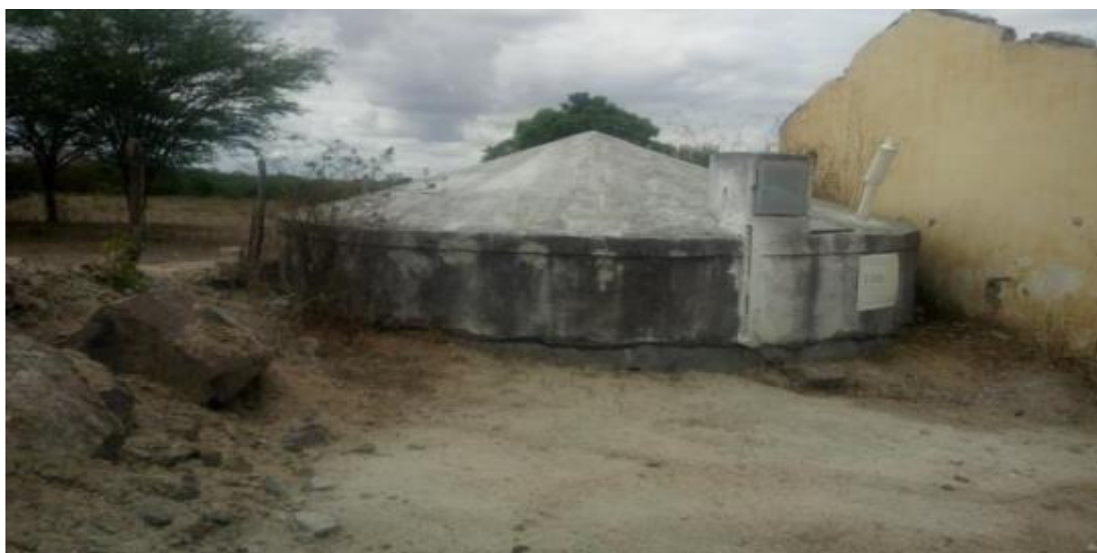
Figura 87 – Cisterna Localidade Cansanção Fonte: INSTITUTO GESOIS, 2021.
