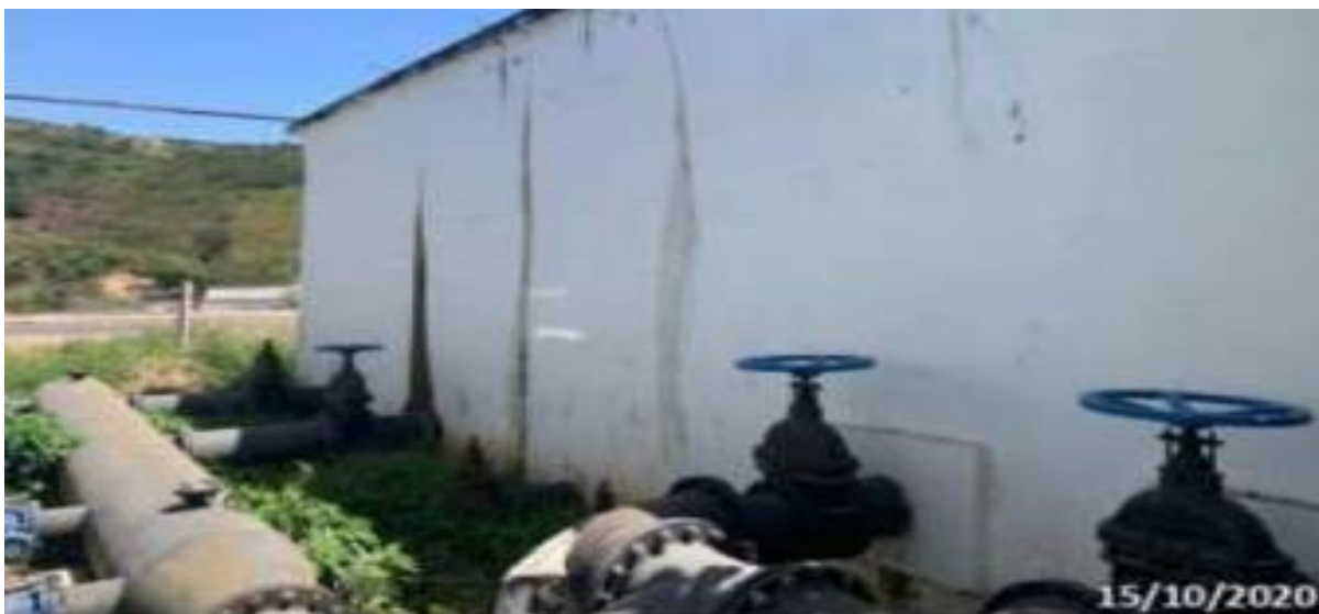
Figura 30 – Reservatório R1, EEAT- 05 de Água Branca Fonte: ARSAL, 2020.
