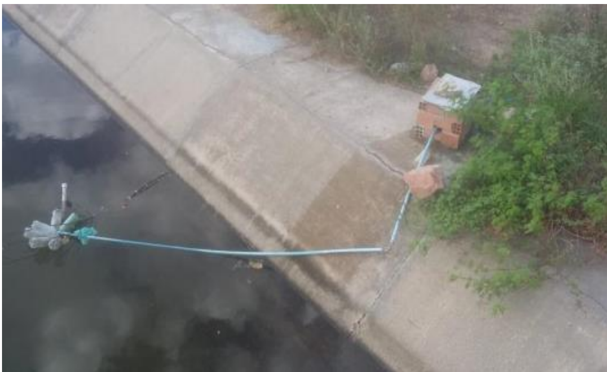
Figura 81 – Captação no Canal do Sertão Localidade Riacho Novo Fonte: INSTITUTO GESOIS, 2021.
