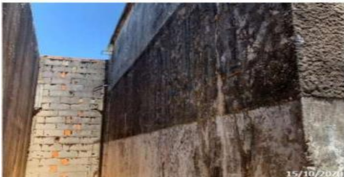
Figura 33 – Reservatório R2, EEAT Auxiliar de Água Branca Fonte: ARSAL, 2020.
