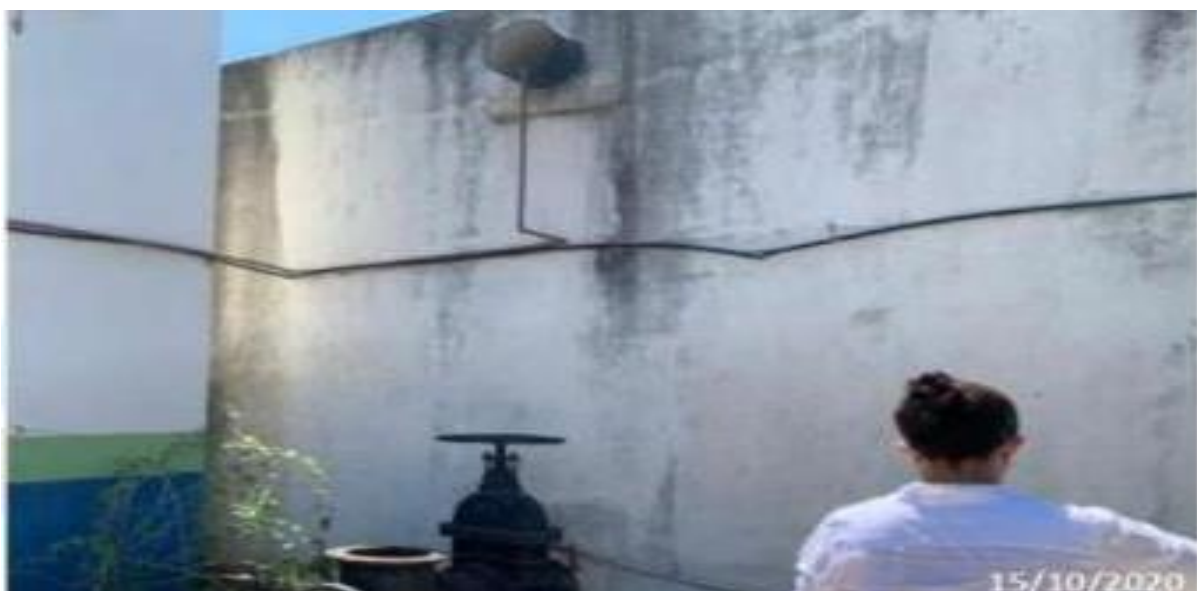
Figura 31 – Reservatório R2, EEAT- 05 de Água Fonte: ARSAL, 2020.
